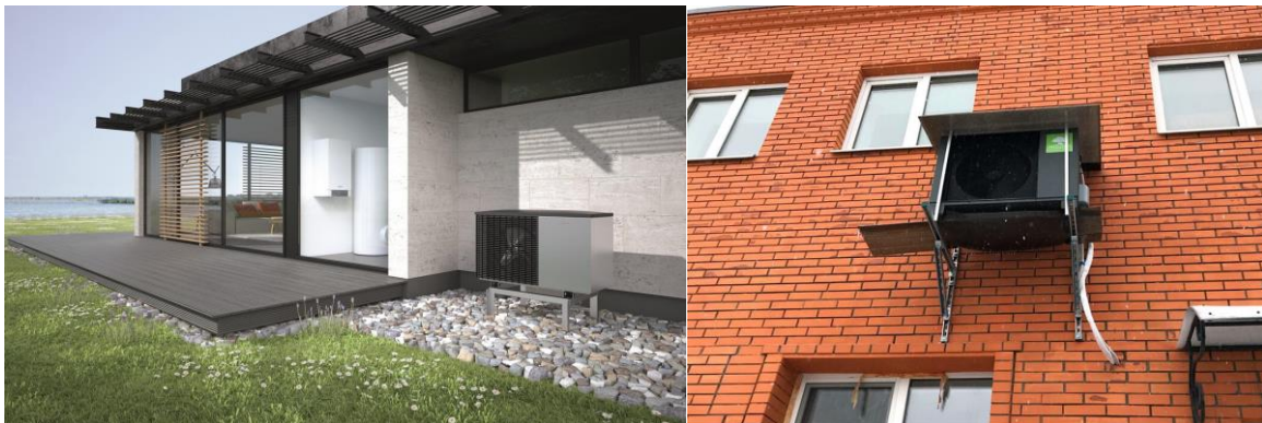
Рисунок 3.2 – Приклади установки теплових насосів
