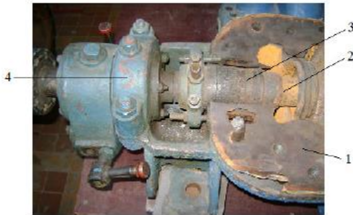
Рис. 1.13. Зношування валу відцентрового насоса: 1 – корпус; 2 – кавітаційний знос; 3 – гідроабразивний знос; 4 – корпус підшипника
