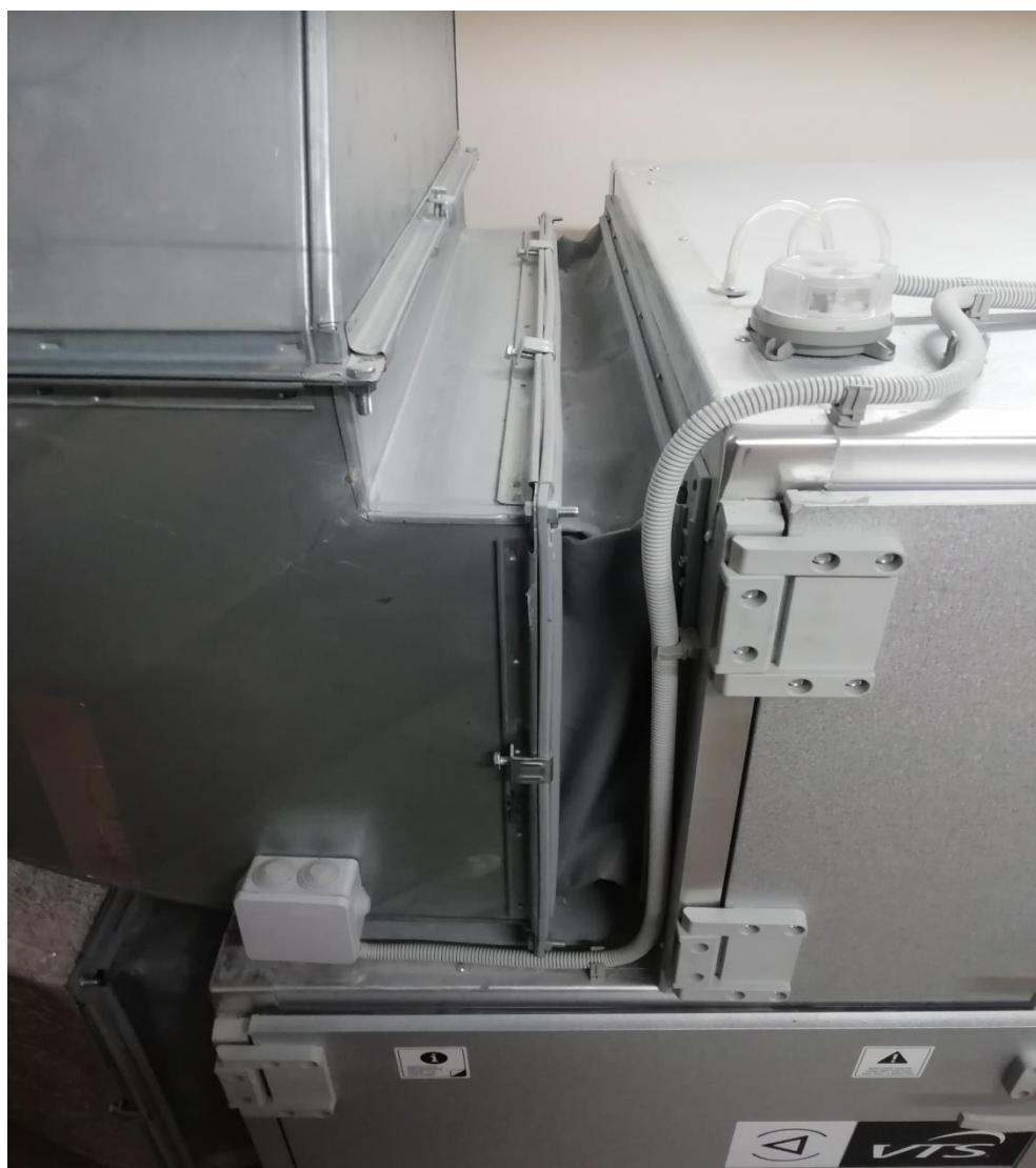
Рисунок 2.4. Гнучке з'єднання вентиляторної секції
