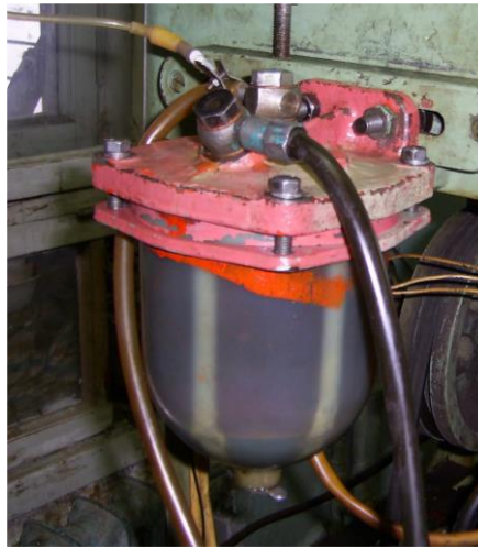
Рис. 2.6. Загальний вигляд фільтра-вологовідділювача
