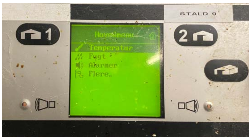
Рис.11 Датчики системи контролю і сигналізації, встановлені в приміщеннях ферми.
