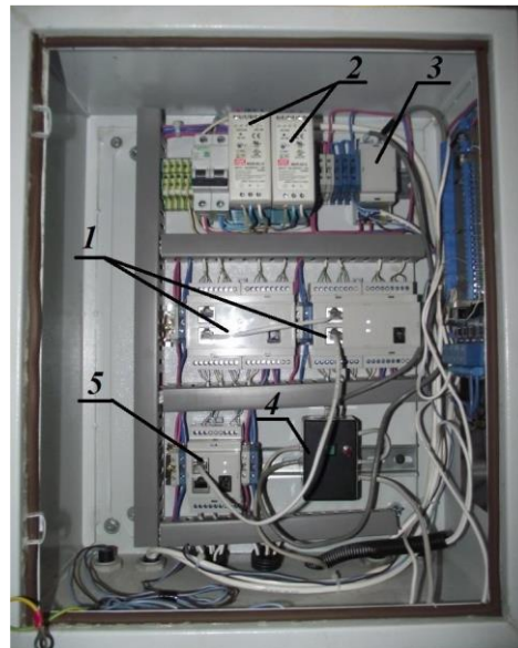
Рис. 2.9. Шафа системи керування сушаркою: 1 – система управління подачею агента сушіння в сушильні камери; 2 – блоки живлення; 3 – блок силової комутації; 4 – блок керування теплогенератором; 5 – блок керування вентиляторами
