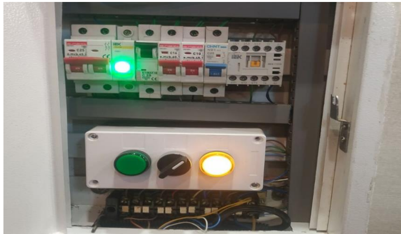
Рисунок 3.5 – Електричний щит моделі вуличного освітлення
