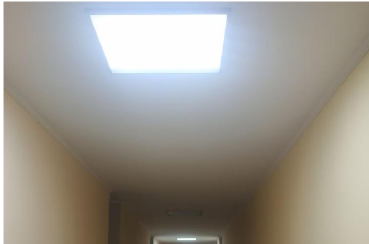
Рисунок 1.7 – LED-світильники коридорного освітлення.
