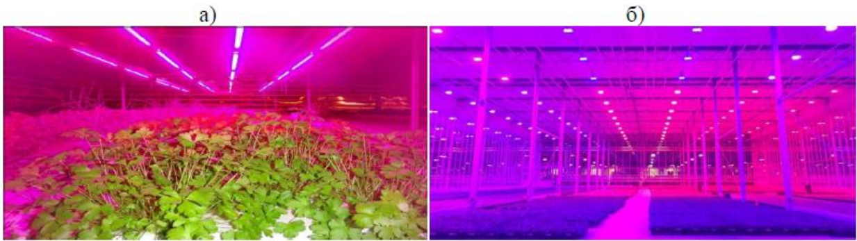
Рис. 1.4. Промислові світлодіодні світильники: а) теплиця в Голландії зі світлодіодними світильниками Green Power LED; б) теплиця в США штат Мічиган зі світлодіодними світильниками LumiGrow Pro325e.
