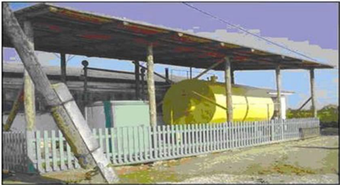
Рис. 1.5. Біореактор-метантенк та газгольдер теплоелектростанції АБЕУ-20
