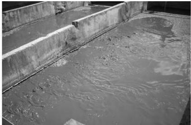
Рис. 2.2. Зовнішній вигляд преаератора
