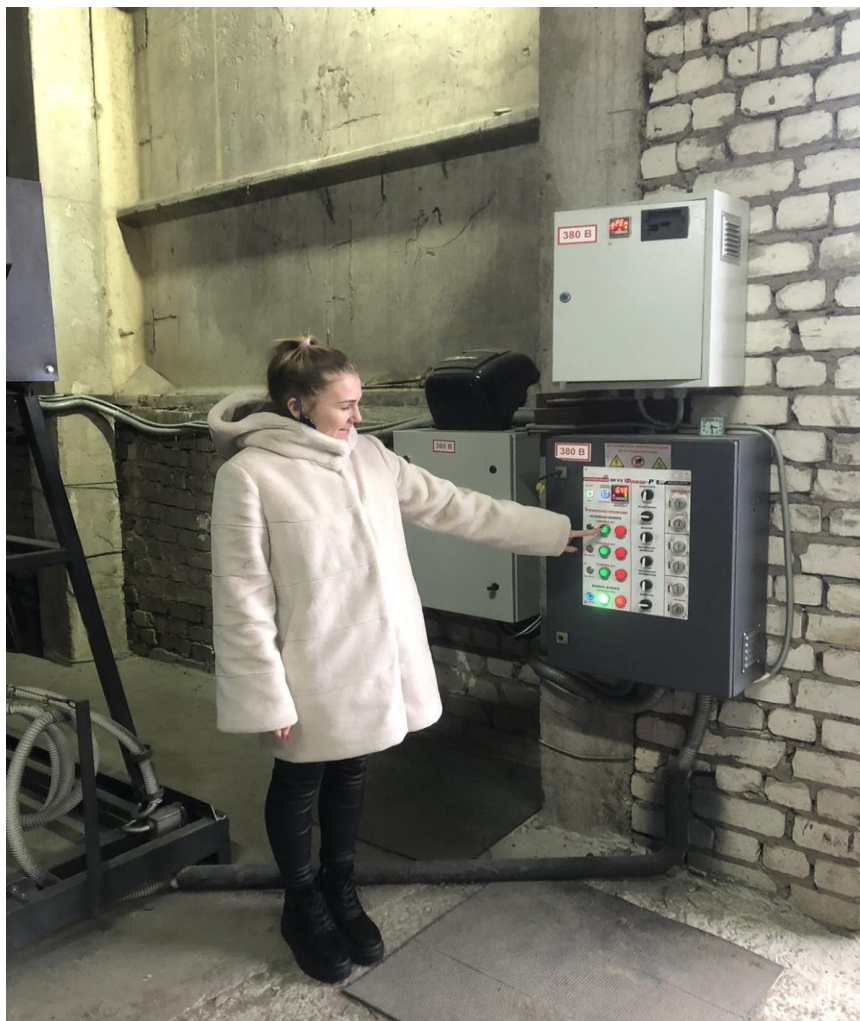
Рис. 11 Електричний щит управління УТ-500Д
