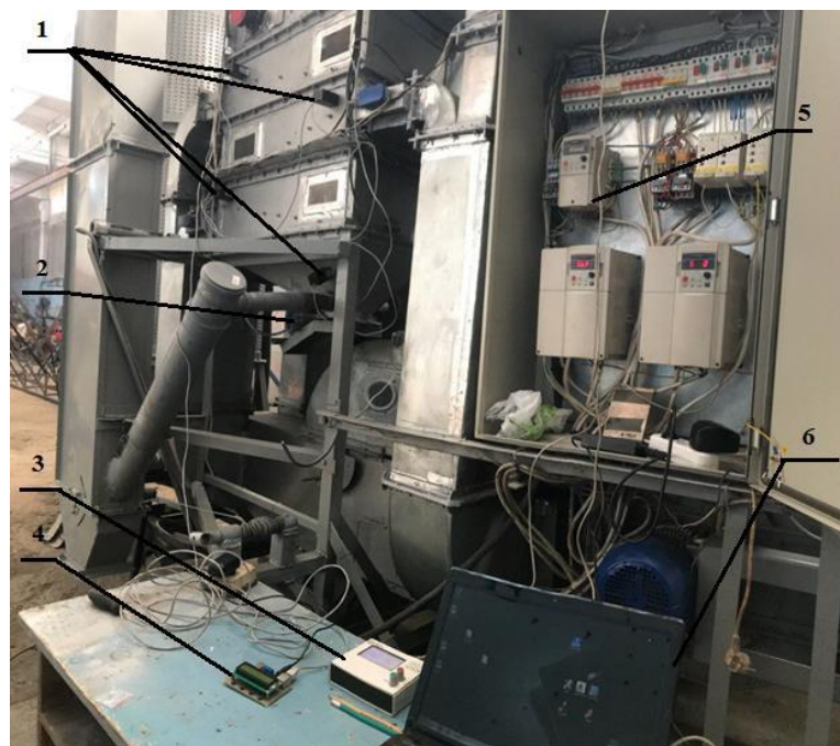
Рис. 2.7. Встановлення та під'єднання виготовленого пристрою в аерожолобній сушарці киплячого шару 1 – пірометричні датчики, 2 – електродвигун вивантажувального пристрою, 3 – пульт керування сушаркою, 4 – пульт керування експозицією сушіння зерна, 5 – частотний перетворювач системи керування електродвигуном вивантаження, 6 – персональний комп'ютер.
