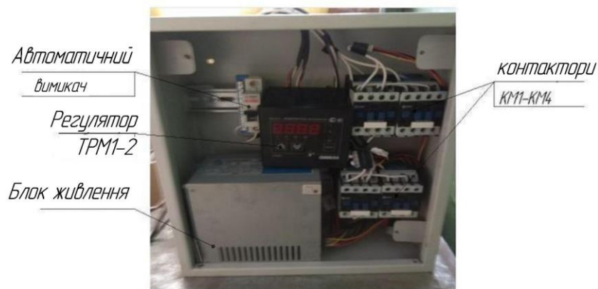
Рис. 2.6. Щит керування автоматизованою системою осушення повітря
