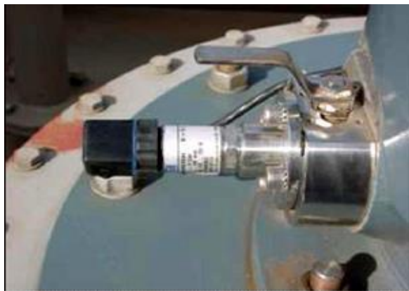
Рисунок 2.12 - Датчик тиску оливи у вводах трансформатора
