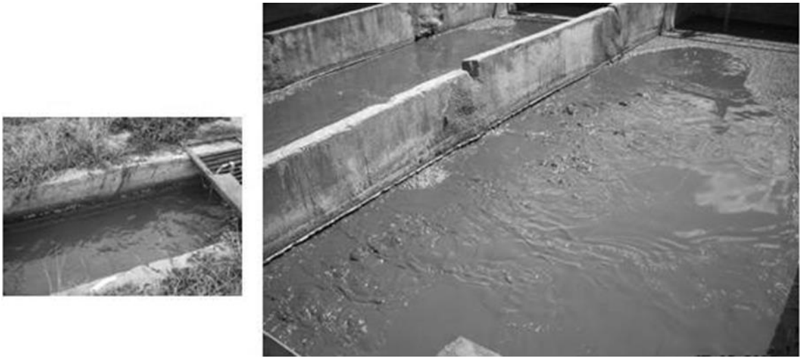
Рис. 2.2 Преаератор в технології очистки стічних вод
