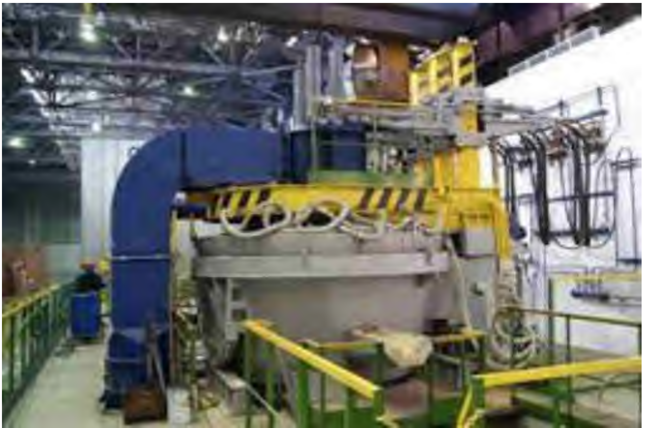
Рис.3.2. Загальний вигляд печі ДСП-3
