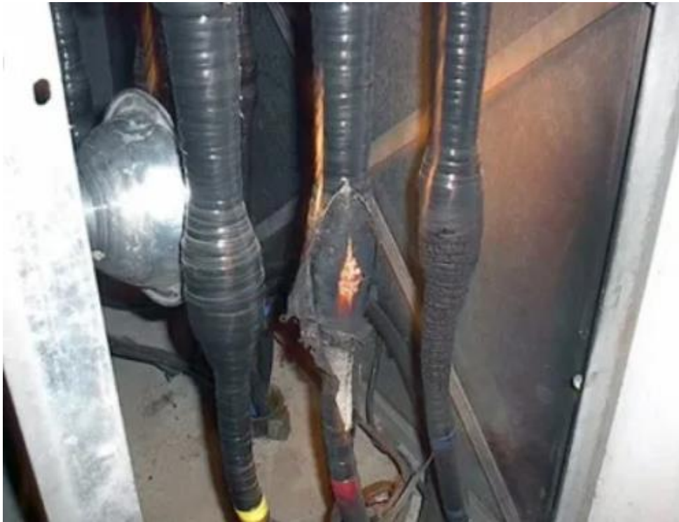
Рисунок 2.2 – «Руйнування ізоляції електрообладнання в наслідок впливу часткових розрядів»
