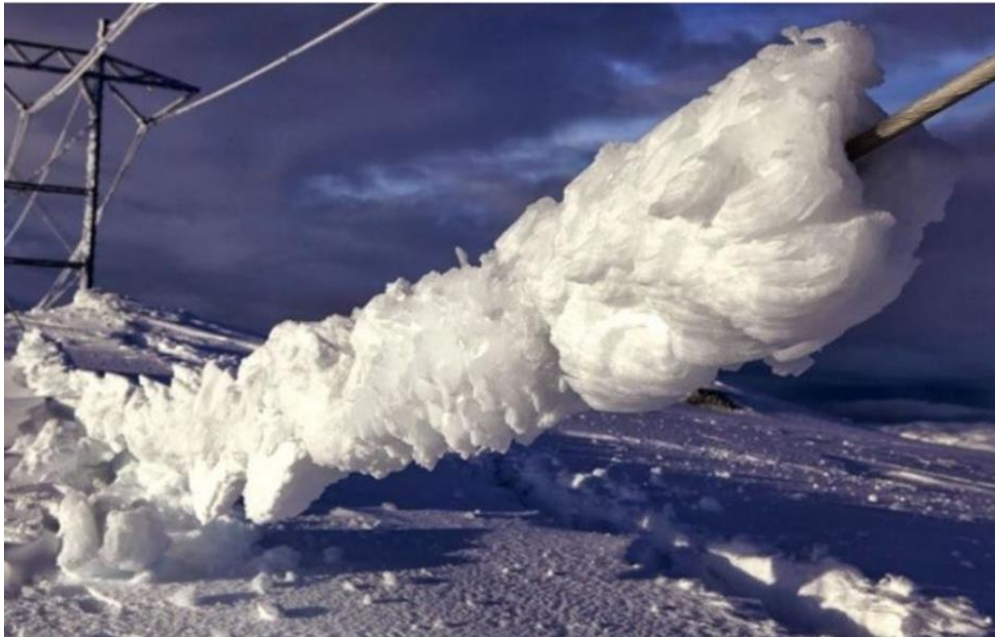
Рисунок 3. Ожеледиця та поморозь на проводах ліній електропередачі.
