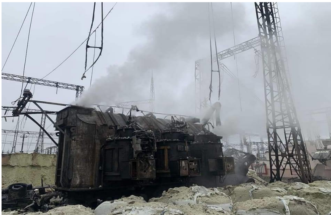
Рис. 1.2 Фото. Уражений трансформатор підстанції крилатою ракетою [15]
