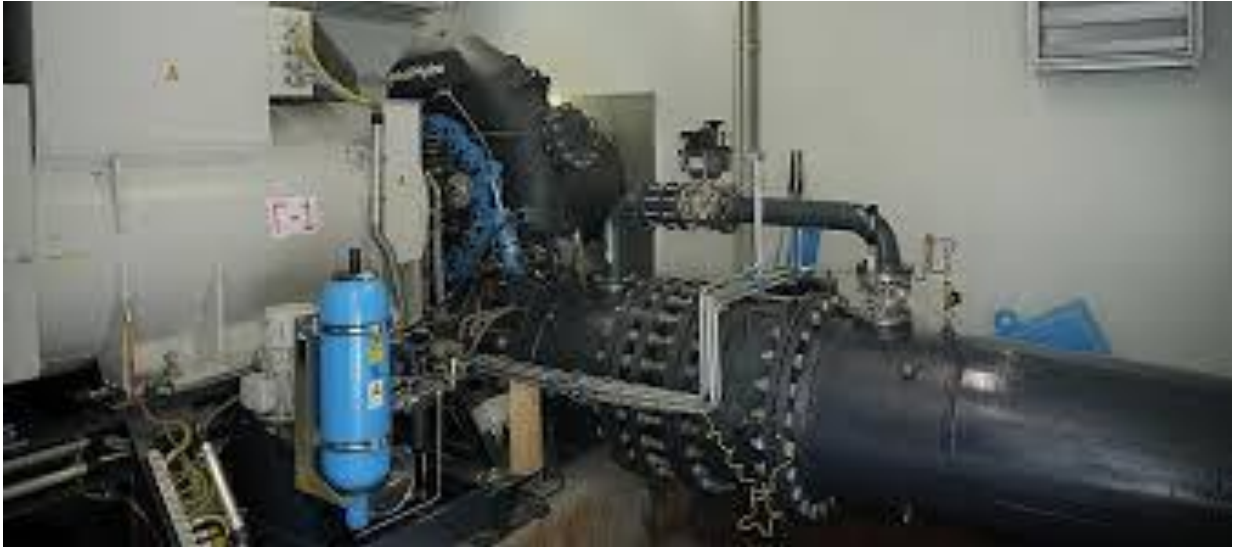
Рисунок 3.6. Загальний вид установок рекуперації тиску
