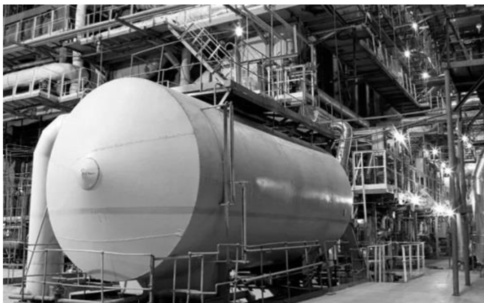
Fig. 2. Hydrogen storage (Kudria, 2019)
