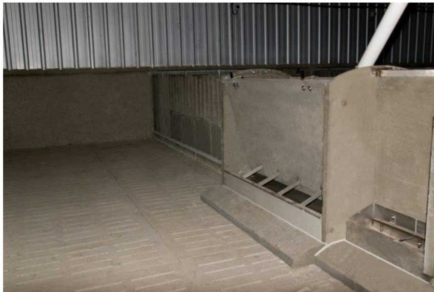
Рис. 1.2. Комплект вітчизняного обладнання (ТОВ «VIP Бетон») для свинарника-відгодівельника
