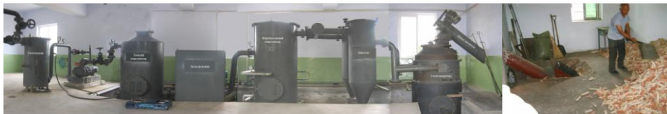
Рис. 4. Газогенераторна станція потужністю 150 кВт що, працює на рослинних відходах (Китай)
