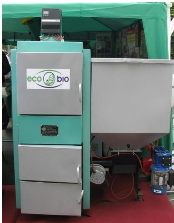
Рис. 11. Загальний вигляд котла-автомата КОВА–25, що працює на паливних гранулах
