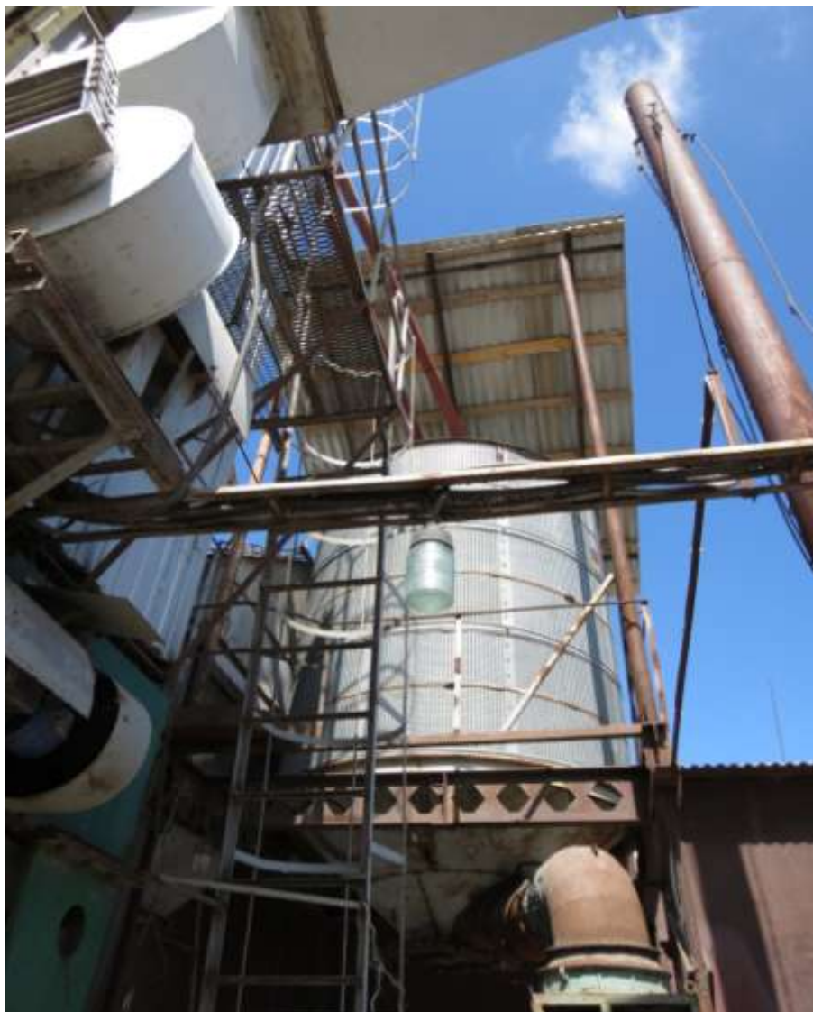
Рис. 3. Зерносушильный комплекс, оснащенный прямоточковым газогенератором (зерносушарка шахтного типу ЗШ – 1000)
