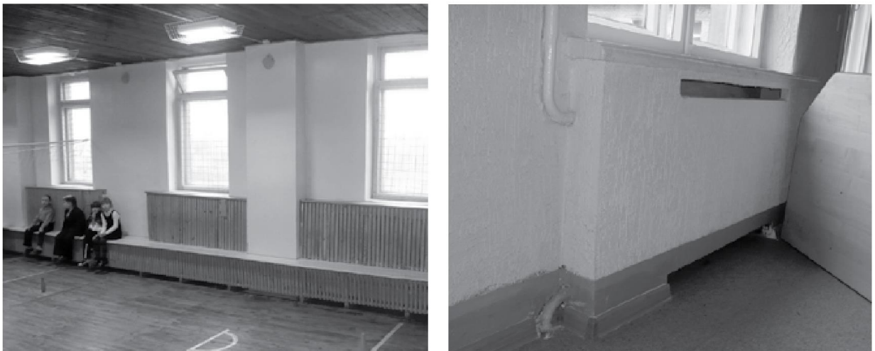
Рис. 2.5. Огорожа радіаторів опалення в будівлі ЖОДЮСШОІ
