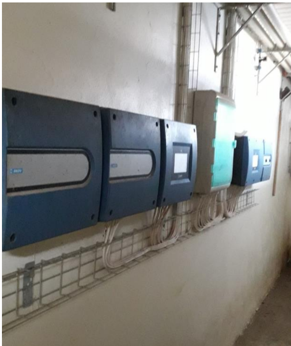
Рис. 3.2. Блок керування мікрокліматом приміщень
