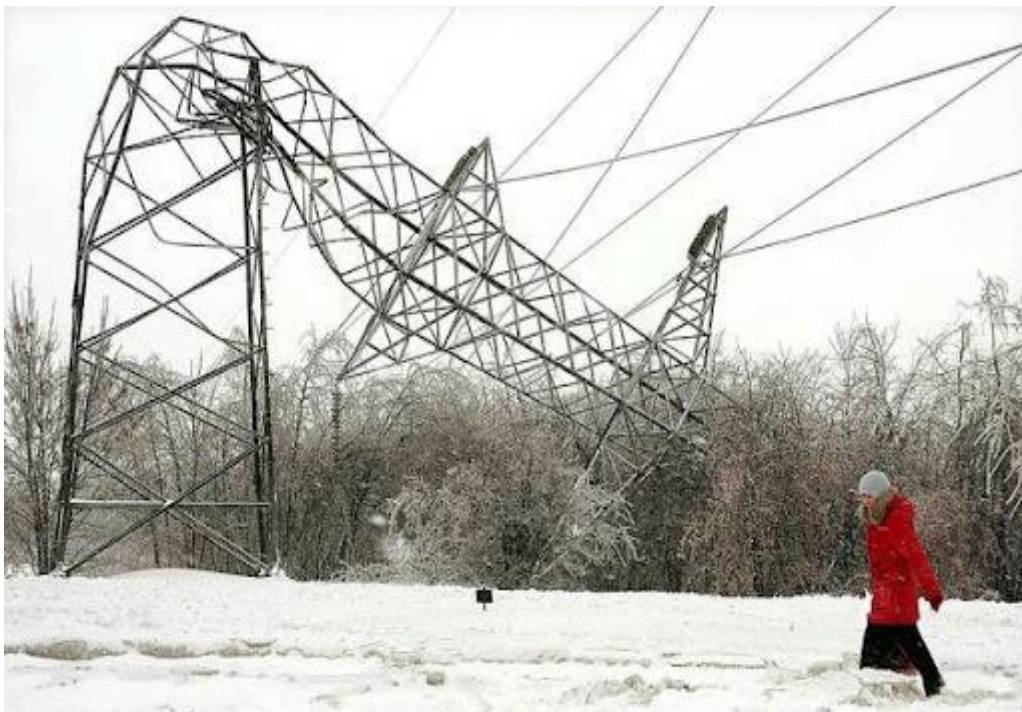
Рисунок 10. – Пошкодження опори внаслідок утворення льоду
