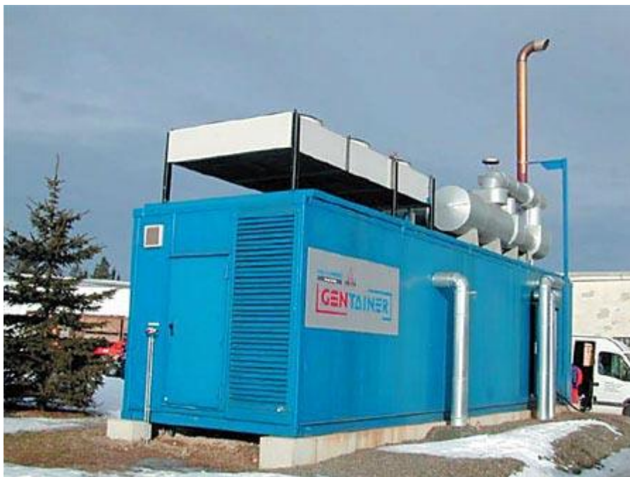
Рисунок 3.3 - Когенераційний агрегат MWM (колишній DEUTZ Power Systems) у контейнерному виконанні з двигуном TBG 616 V16
